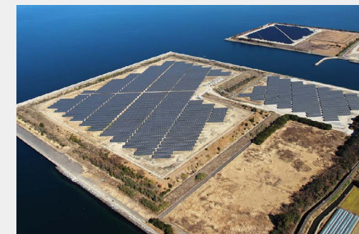
大村メガソーラー発電所
